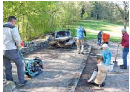
Fronarbeit zur Erneuerung und Auffrischung von Boden, Tisch und Grill auf dem Rastplatz Stalden (hinter Schloss).
